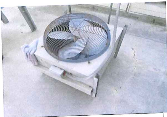
#7: KITCHEN EXHAUST FAN
